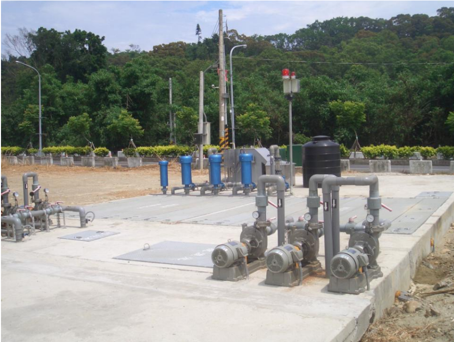
圖 7-1 1200 CMD MBR 污水廠全景。
